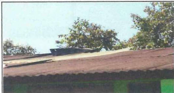
Foto 1: Se observa desprendimiento del capote además del levantamiento de láminas del aula 11 del módulo No. 4.
