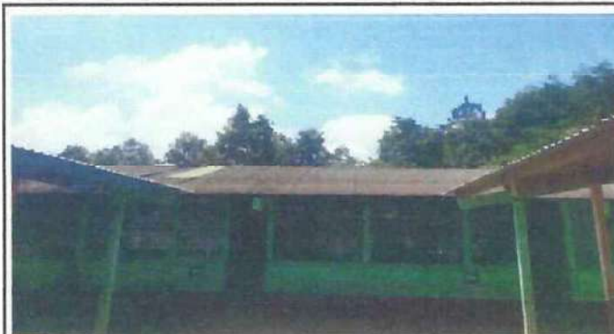
Foto 2: Se Observa deterioro de la división de las láminas del módulo No. 4.
