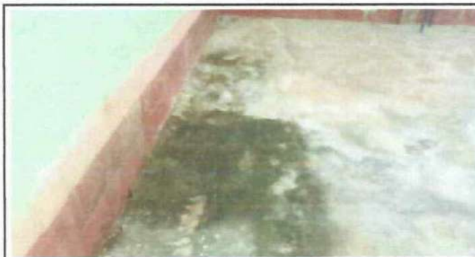
Foto 4: Se observa la proliferación de moho en el suelo por la calda de agua, debido a la falta de láminas en el techo del aula 9 del módulo No. 4.
